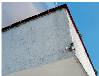
Die periodische Kontrolle von Flachdachentwässerungen ist zwingend notwendig, damit keine Rückstaugefahr besteht.
